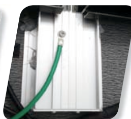
05 Mise à la terre du système
