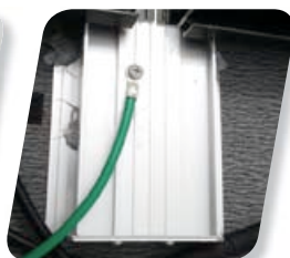
05 Mise à la terre du système
